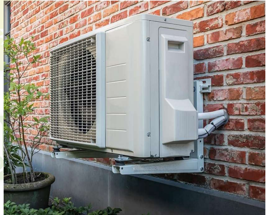
Une pompe à chaleur
